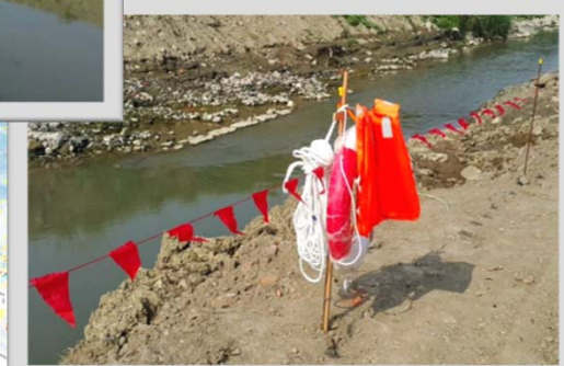
臨水救生設備
