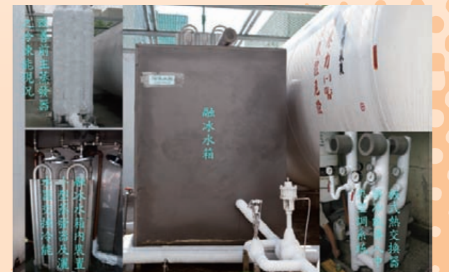
液氧槽再生能源
