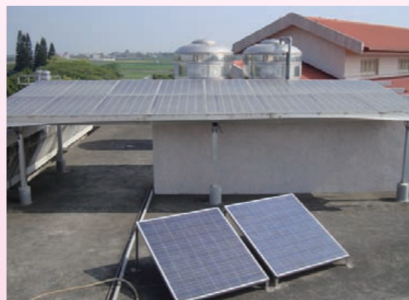
太陽發電科技設施
