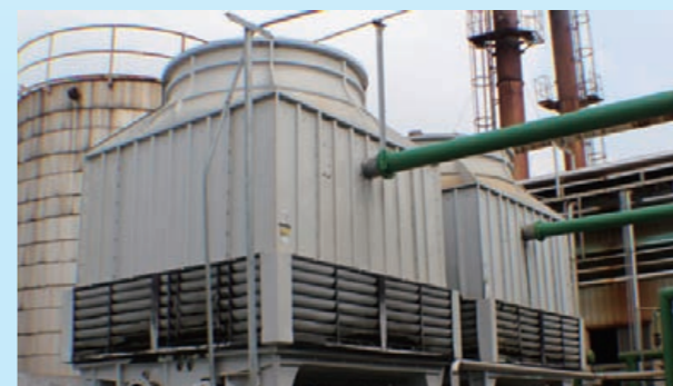
更新高效率冷卻水塔
