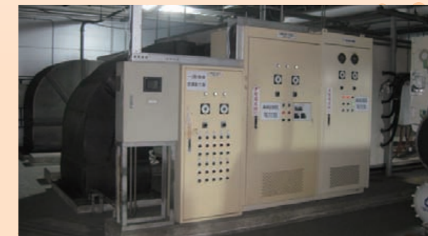
空調箱節能控制及操作管理改善
