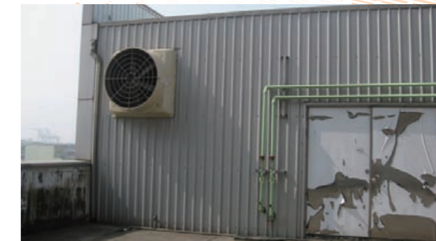
變電站冷氣停用改通風排氣降溫
