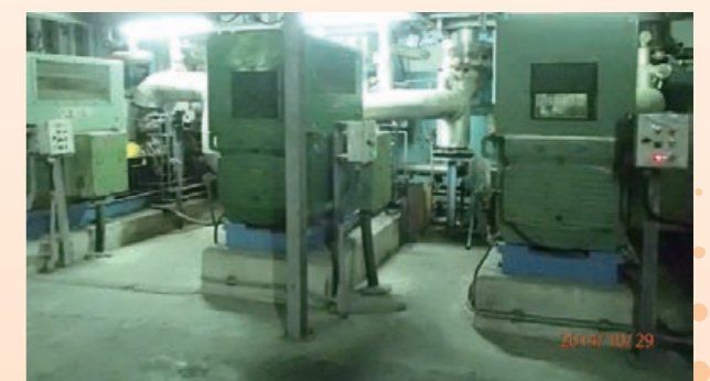
改變鍋爐飼水泵運轉模式
