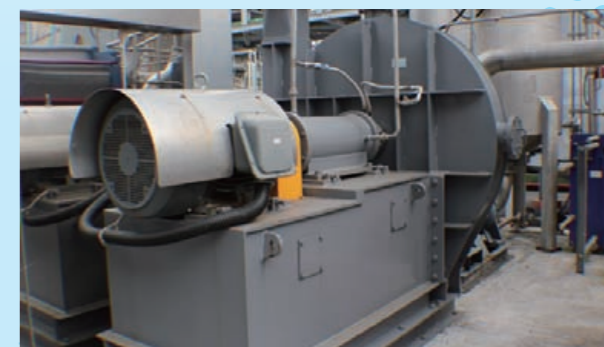
增設 MVR 提高蒸氣使用效率
