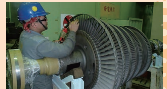
定期檢修維持蒸汽渦輪發電機高效率運轉 - 汽輪機葉片檢修
