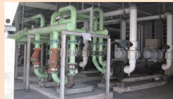
冷卻水管路並聯改善
