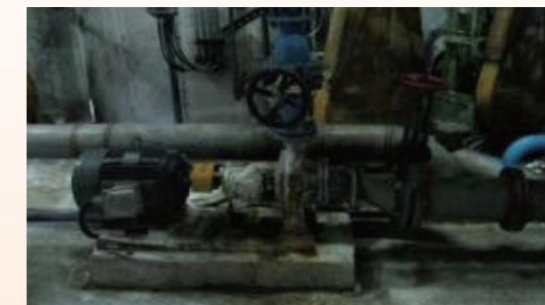
7 號機白水系統 MP2D1 泵浦改自動
