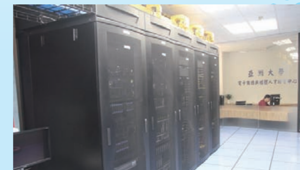
綠能資訊機房，採高效冷熱分流建置
