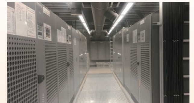
高效率通信機房
