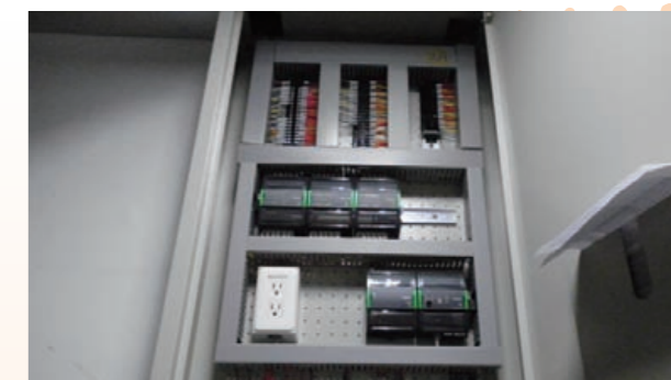
冷氣機 DDC 控制器
