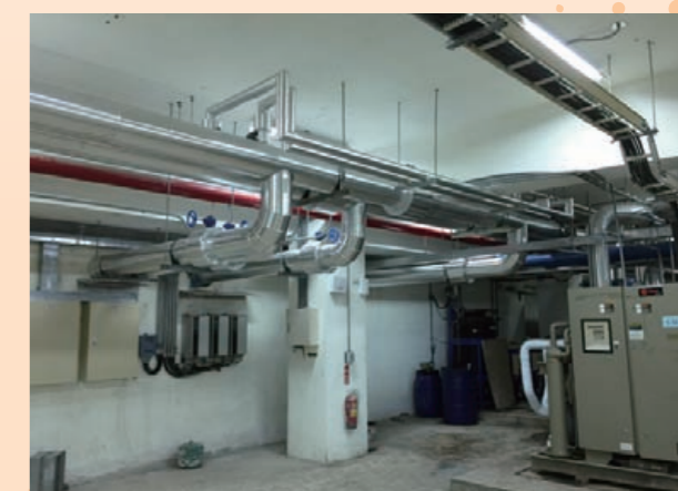
五館空調系統整併提昇效率
