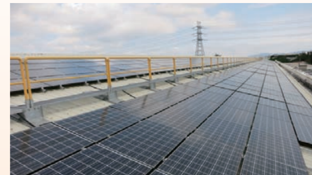
太陽能發電系統設置
