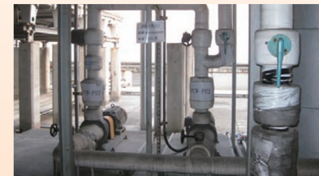
製程冷卻水系統管路連通整併共用
