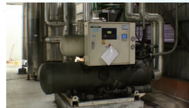
新增冰水機熱泵取代蒸氣
