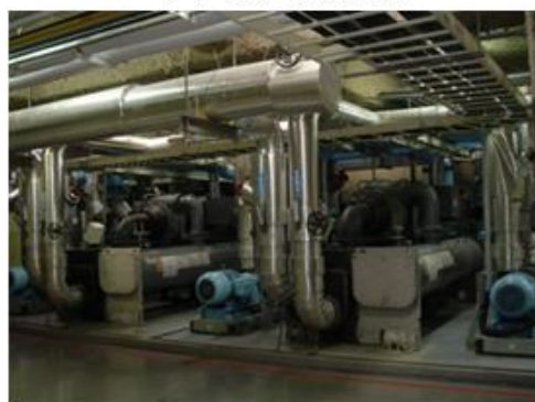
平安樓空調主機
