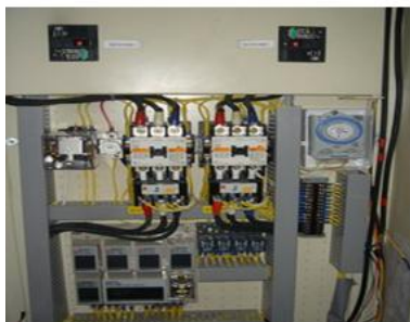
控制電路加裝定時器
