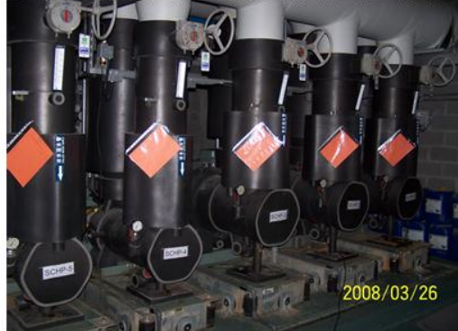
公共二次冰水系統採日夜變頻模式控制，共5台
