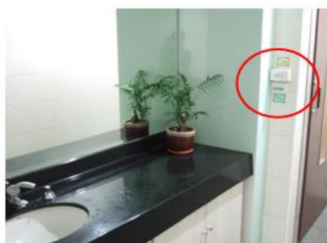
廁所照明設備加裝紅外線感應器 控制開關以節約用電
