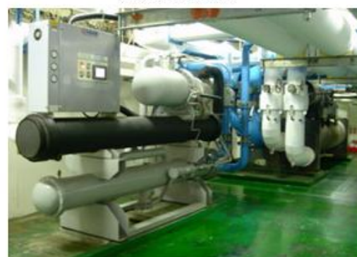
喜樂樓空調主機
