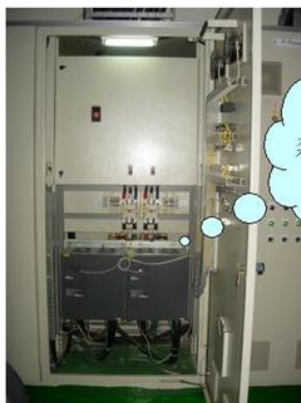
使用變頻控制措施照片
