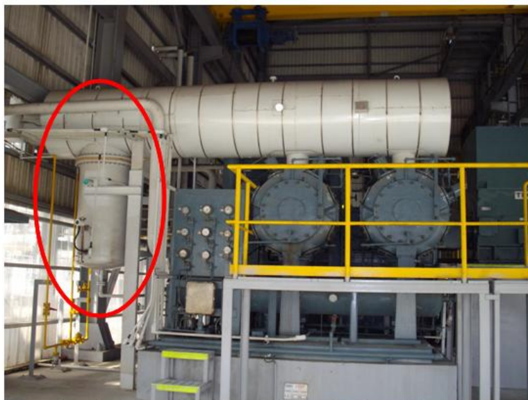
製程氣體回收壓縮機(B-320)入口增設去除槽(V-321)
