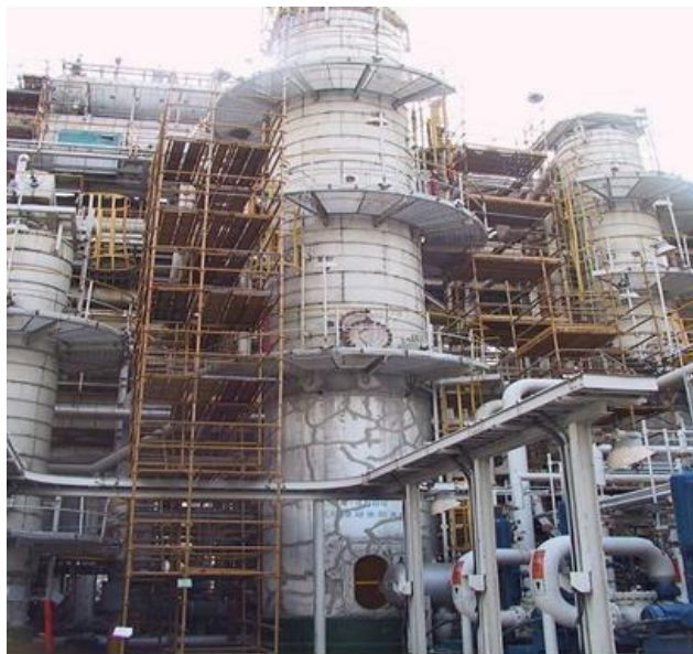
酸水汽提單元(SWS)V-4884 冷凝水閃變槽。
