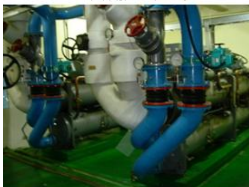
恩典樓空調主機
