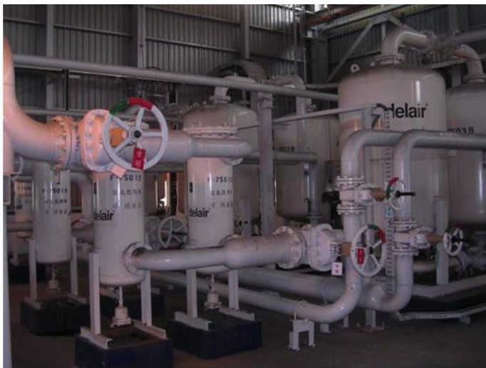
舊系統無熱式乾燥機(設備已拆除)
