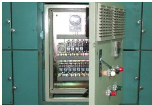
配電大樓空調系統可程式控制開關
