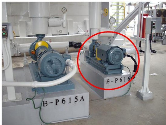
配合粗EG槽(T-615)改採少量回收之需求，輸送量由108M 3 /Hr (原有P-615)降低為10M 3 /Hr (新設P-616)，以節省電力。
