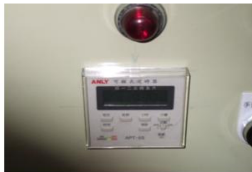
南、北棟大樓空調系統可程式控制開關
