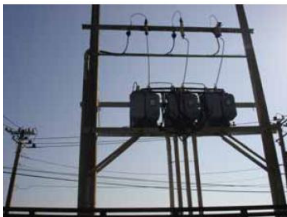
戶外高壓電容器拆除前
