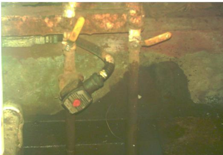
改善前液位開關(Level switch)。
