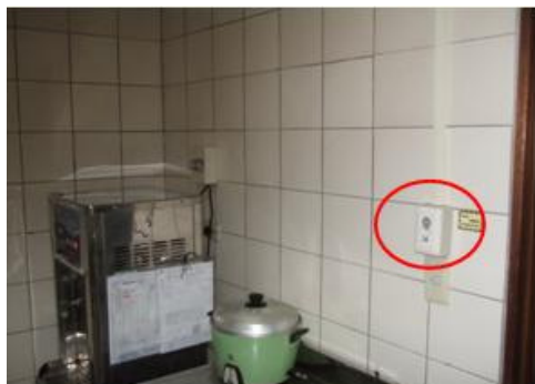
茶水間之照明設備加裝紅外線感應器 控制開關
