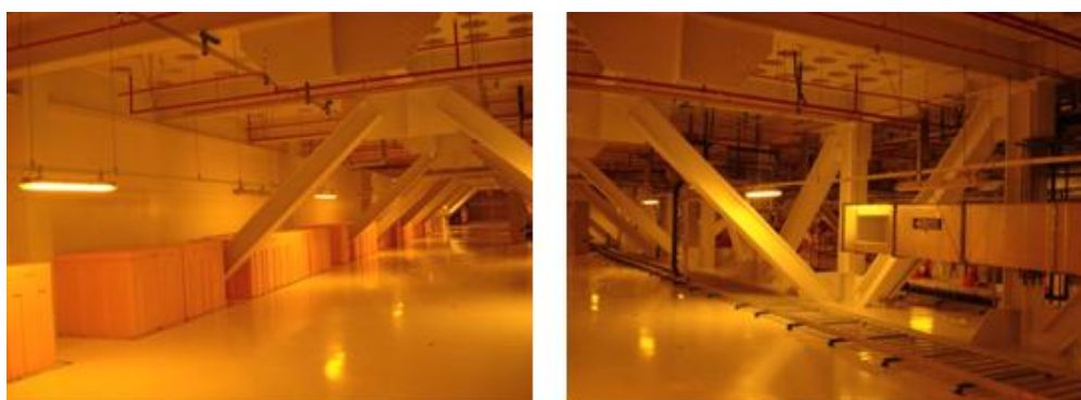
圖一 無塵室 Subfab 區域照明燈具隔蓋點亮
