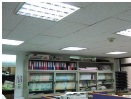
辦公室照明改善前狀況
