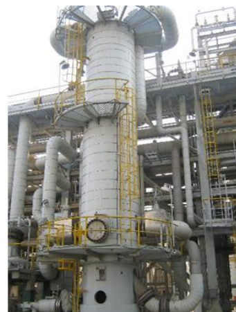
新設之板式換熱器外觀照片。(E-2112/2212)
