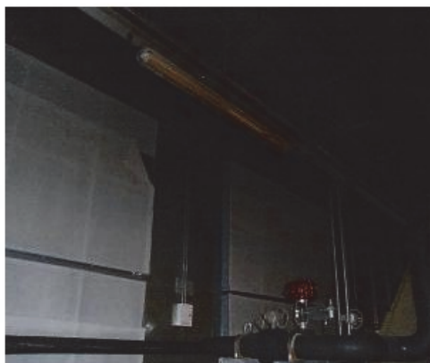
2)FAB-1 truss area照明開關關閉後
