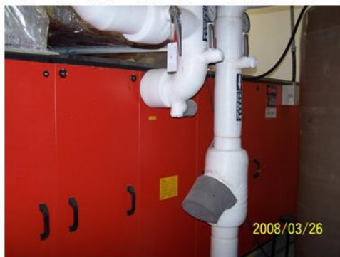
辦公大樓及部份餐廳空調箱由中央定時變頻控制，共16台
