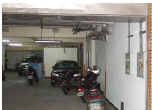
配電大樓未加裝感應器前情形
