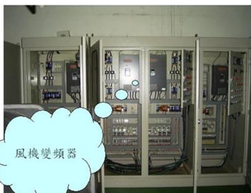
使用變頻控制措施照片
