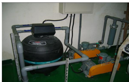
過濾、曝氣設備
