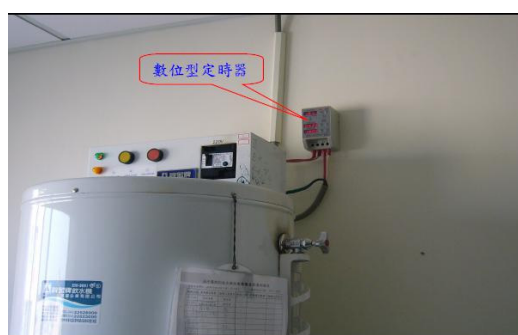
行政區域開水機安裝定時器
