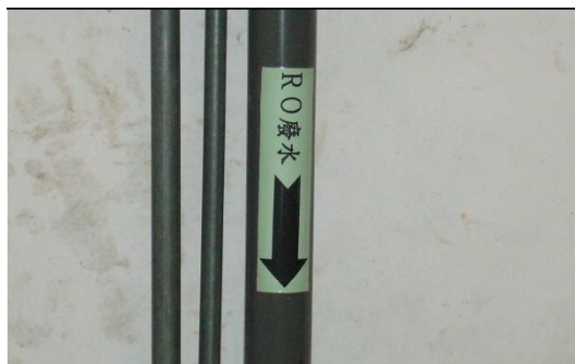
洗腎室及開刀房廢水導引至衛生用水池
