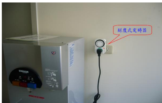
公共區域飲水機安裝定時器
