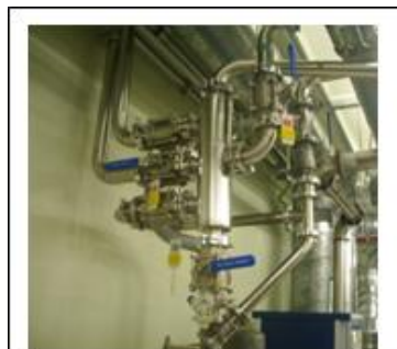
CDO#1 DRY pump EA 管路
