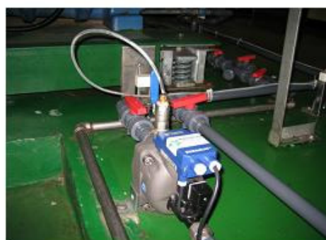
CDA#4 空壓機二段增設無耗氣式排水器
