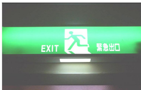
改善前：一般型出口方向指示燈約16W
