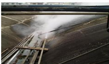
濕料乾燥機未使用冷凝水前
