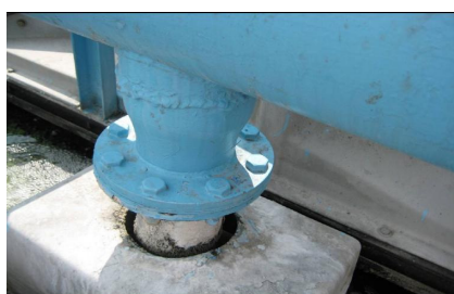
冷卻管路分歧出口大小頭縮小一號
