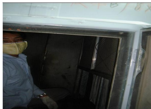
空調箱濾網更換
