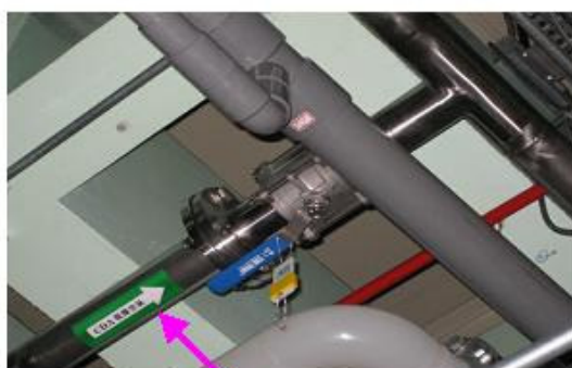
FAB 增加 CDA 65A 主管路
