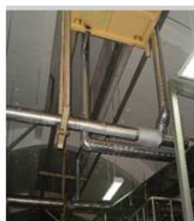
熱交換器回收之冷凝水管路
