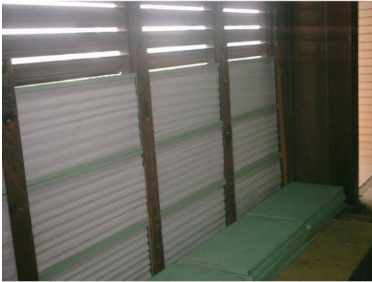
空調機房外牆以活動擋風板過濾並管控外氣量
