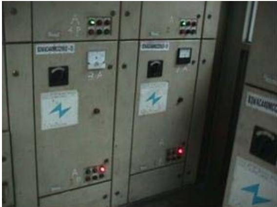
冷卻水泵浦控制電源開關
