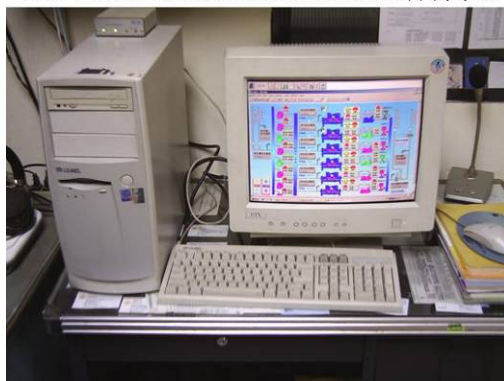
利用中央監控系統隨時監視空調設備的負載情況
