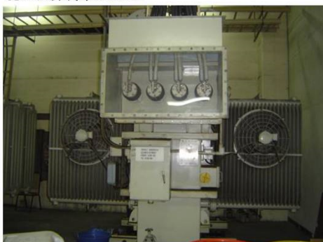
變壓器負載6,000KVA
