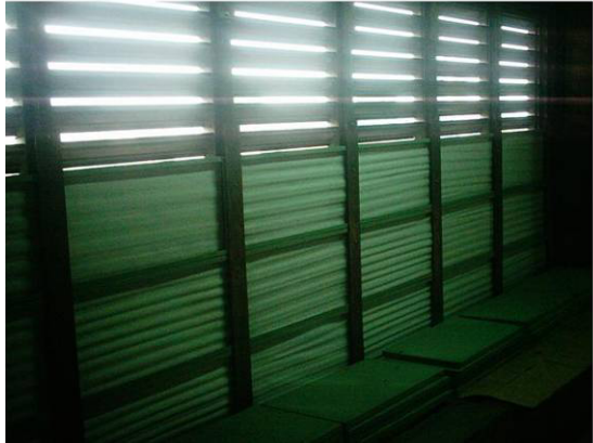
空調機房外牆以活動擋風板可間接減少機房受到西曬的影響
