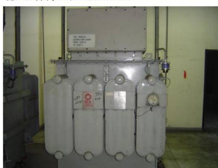
變壓器負載現場照片750KVA
