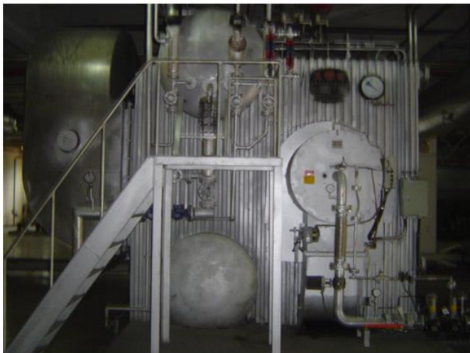
新院區鍋爐燃料油改採天然氣
