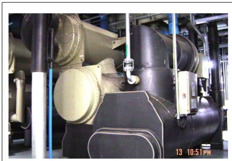
熱回收冰水主機
