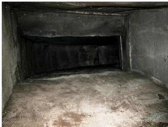
病房區送風管未更新前
