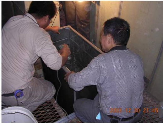
病房區送風管更新後解決所有問題並節省能源的損耗
