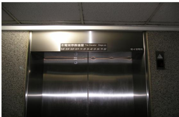
北棟電梯2部行駛低樓層
