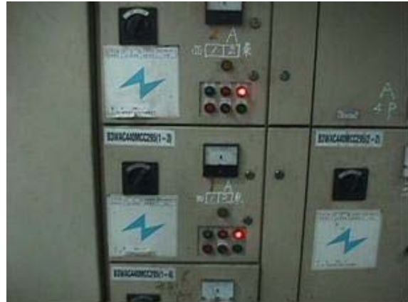
冷卻水風扇控制電源開關
