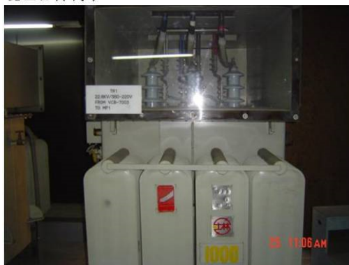
變壓器負載1,000KVA
