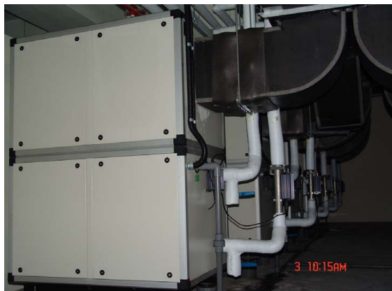
宿舍熱泵主機
