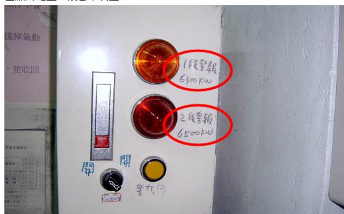
全廠用電量 2 段警示裝置
