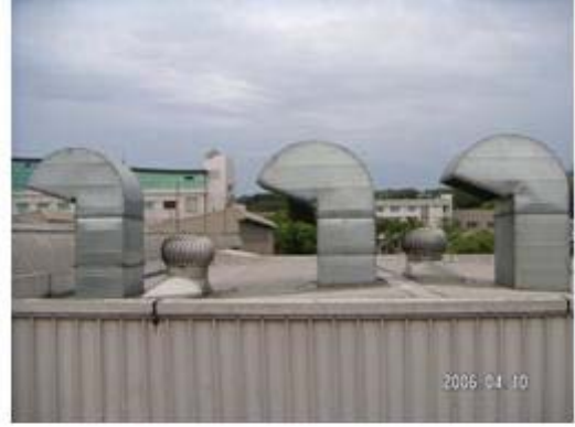
調漆間空壓機排風口
