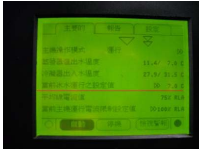
冰水主機冰水出水溫度設定在7.0°C
