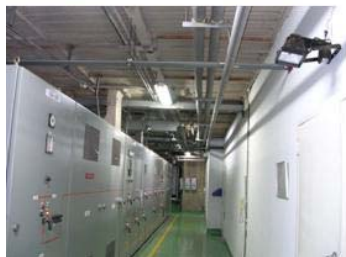
← 機房內設置 自動點滅器
