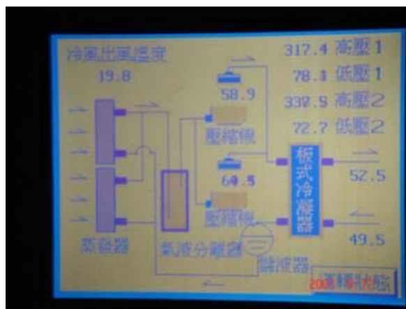
〔空氣對水熱泵系統主機控制系統〕
