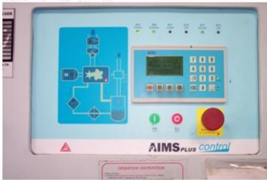
變頻空壓機控制面板
