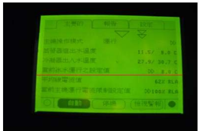
冰水主機冰水出水溫度設定在8.0°C
