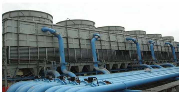
一般冰水主機冷卻水塔現場實景×6台
