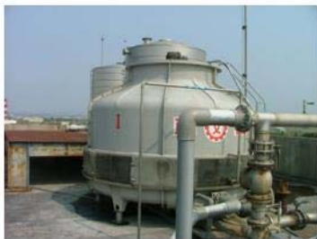
沼氣發電機冷卻水塔
