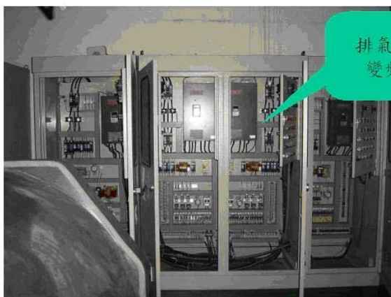
使用變頻控制措施照片
