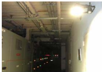
← 機房內設置 自動點滅器
