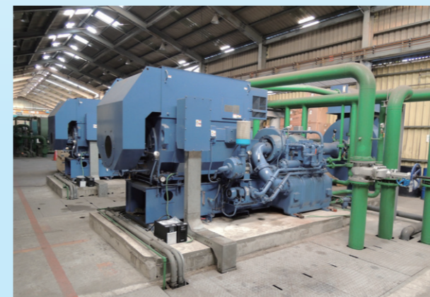
電能節能改善 - 採用高效率空壓機取代舊空壓機做基載
