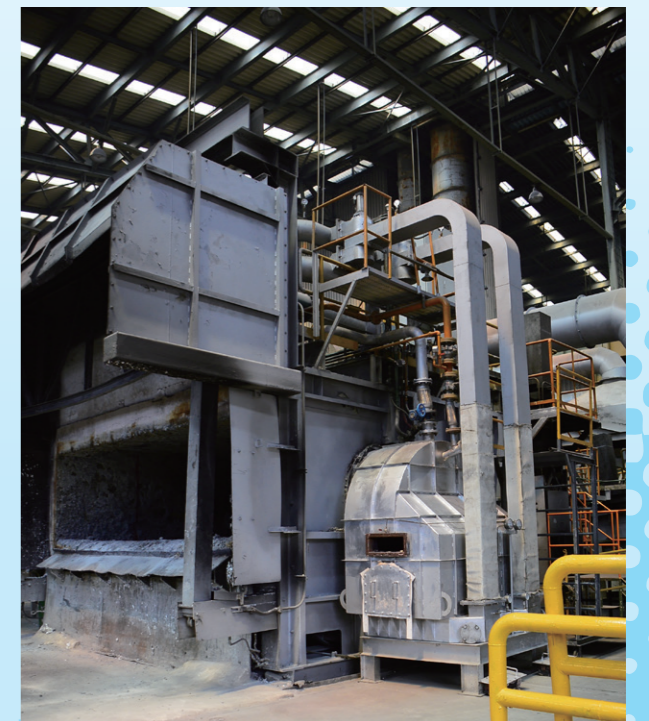
熱能節能改善 - 採用蓄熱式燃燒器節能
