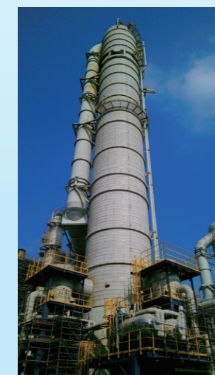
乙苯循環塔分離效率提升改善 (水運轉測試)
