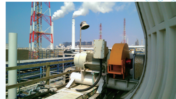
冷卻水塔風車加裝永磁式調速器節電改善
