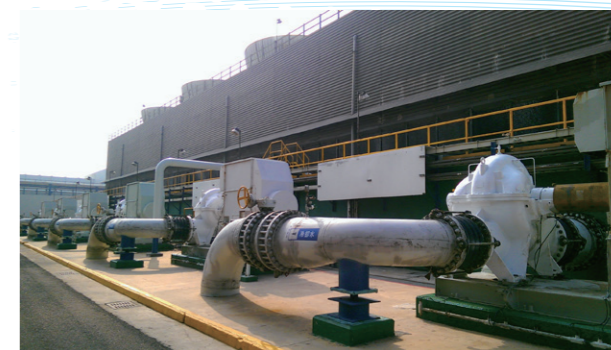
冷卻水塔泵浦內部 Coating 節電改善
