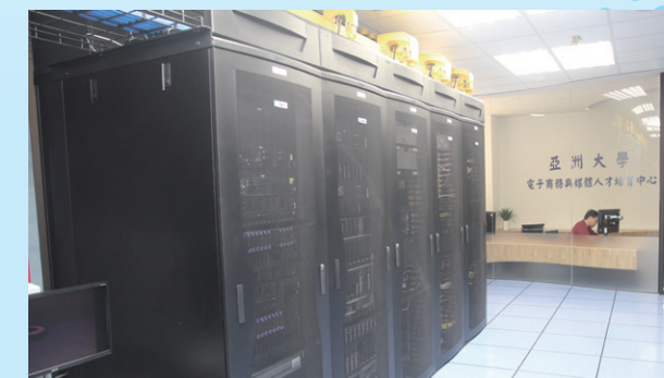
綠能資訊機房，採高效冷熱分流建置
