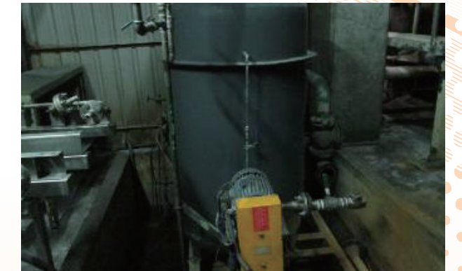
設置七號紙機汽水分離真空泵浦
