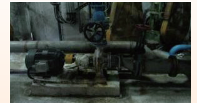
7 號機白水系統 MP2D1 泵浦改自動
