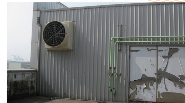
變電站冷氣停用改通風排氣降溫
