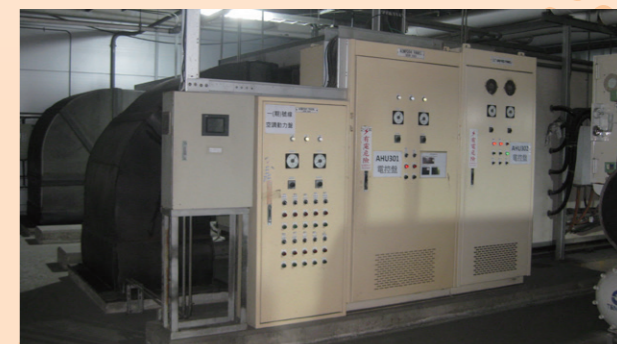
空調箱節能控制及操作管理改善
