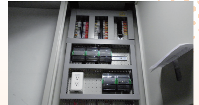
冷氣機 DDC 控制器
