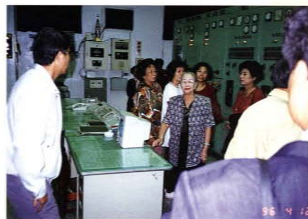
在四維變電所引導民衆參觀，並介紹電氣安全
